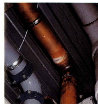
まったく被害のなかった銅管
