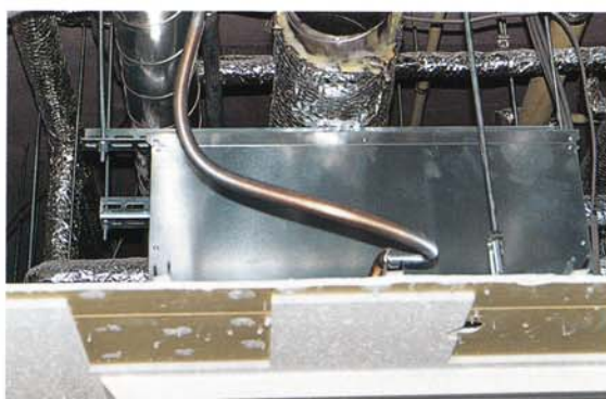
▲スプリンクラー巻出し配管(銅管)は損傷なし(神鋼病院)
