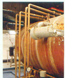
ホテル内給水・給湯はすべて銅管
