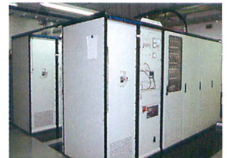
送信機室 送信信号を増幅する大電力送信機を備えている
