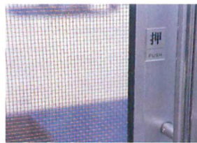
局舎全面に、銅メッシュが使用されている。もちろんガラス扉にもメッシュが入っている
