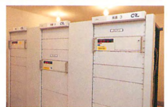
原器室 高性能なセシウム原子時計により時間がつくりられている
