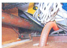
手前船壁にプロパンガス用銅配管がー
