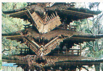
台風により塔の屋根は大被害
