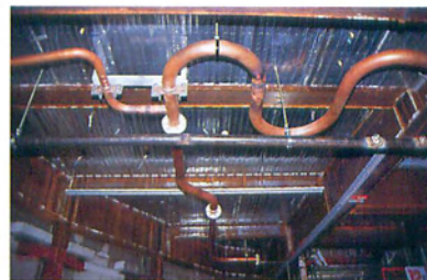
ビル建築に使用される銅管
