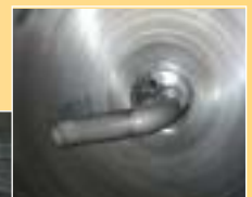
貯湯槽内から見た出湯口 およびエア抜き口
