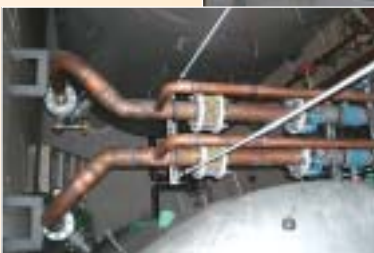
給水管(20A)および還管(40A)接続部
