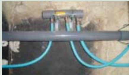
モデルハウスで使用された銅配管
