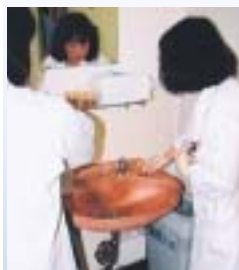
病室内の銅製洗面台
