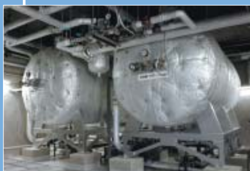
屋上熱源機械室(保温後)
