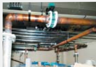
地下階貯水槽まわり配管
