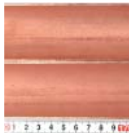
5. 酸洗浄後の内面状況
