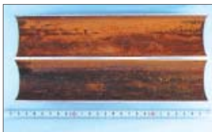
管内面スケール付着状況
