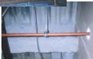
給湯配管に使用される銅管
