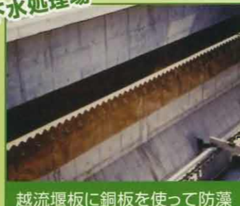
越流堰板に銅板を使って防藻
